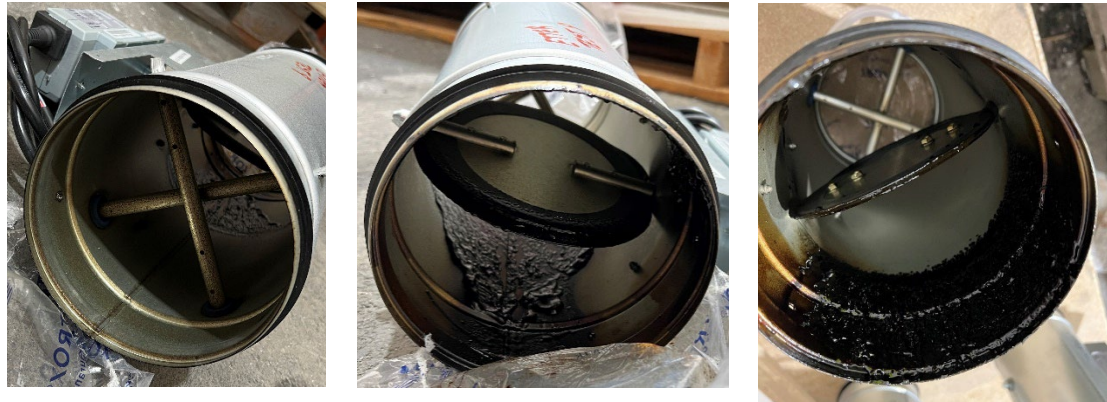
Figur 4-9: Avtrekksspjeld etter test 8. (a) Sot/støv på målekrysset. I (b) og (c) vises det fra to ulike vinkler at svart klebrig sot/støv ble avsatt på innsiden av kanalen nedstrøms for selve spjeldbladet.
