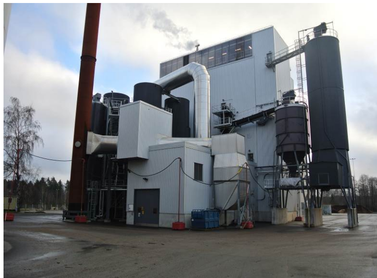
Figure 31: The Jordbro power plant. (Photo: Vattenfall)
