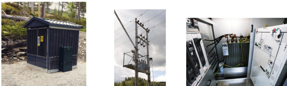
Figur 2.2: Nettstasjons typer. f.v. frittstående nettstasjon, mastemontert transformator, innvendig betjent nettstasjon. Bildene er hentet fra AEN interne database.
