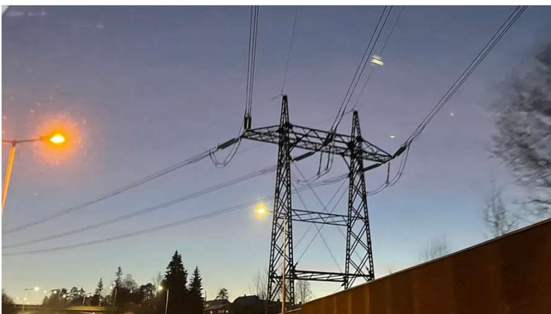
Lokalt distribusjonsnett er designet med en overkapasitet fordi det tidligere ikke har vært mulig å måle kapasiteten lokalt, men nye sensordata gjør dette mulig. Foto: Ellen Synnøve Viseth
