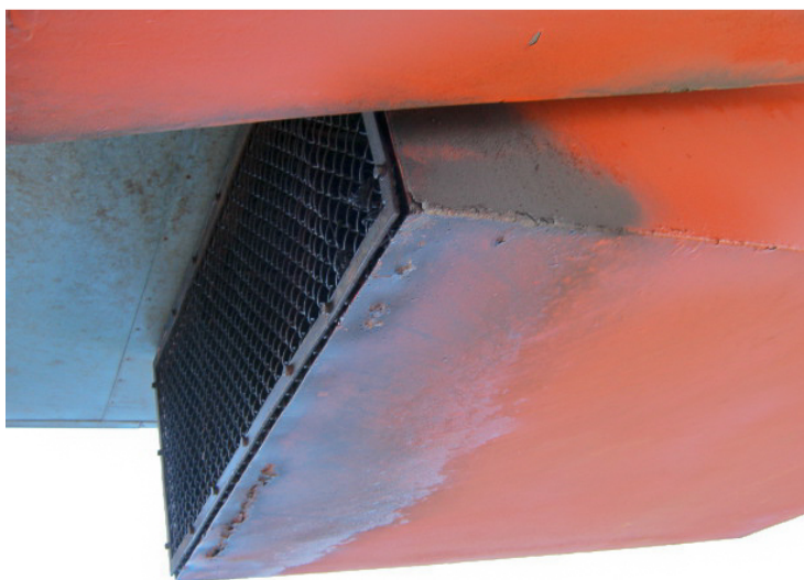
Figur 2 Spor etter kjølevæskelekkasjen omkring luftinntak kranmaskinrom som er plassert under motor A
