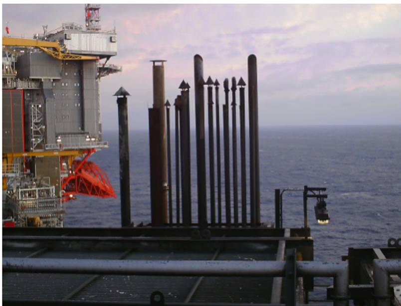
Figur 12 Lysarmatur plassert på vindsiden av avluftingsrørene.
