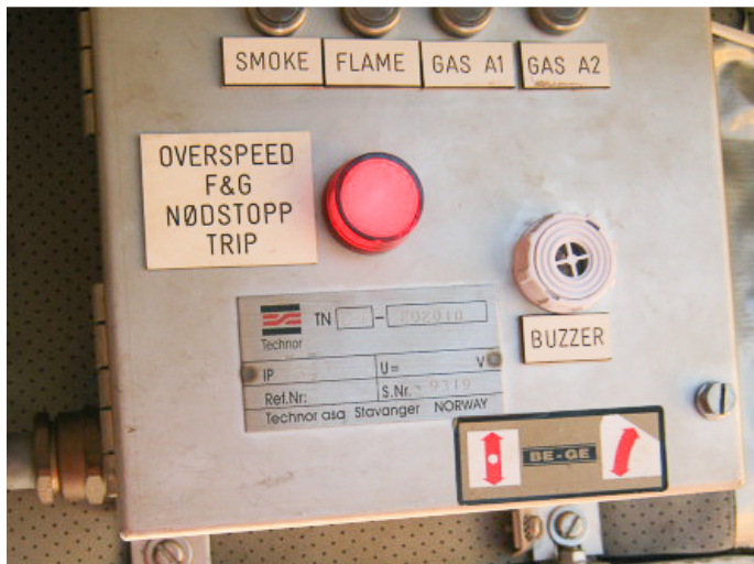
Figur 9 Kranførers brann- og gassalarmpanel i krankabin (PF-035)
