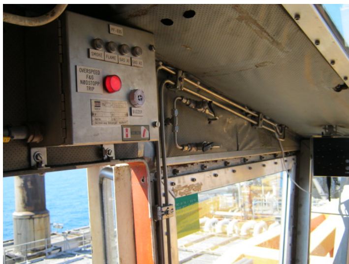
Figur 11 Brann- og gasspanel for lokal varsling av kranfører er plassert bak kranfører og over døren. Lydsignalet er satt ut av funksjon.
