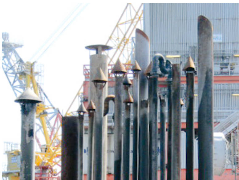
Figur 5 Avluftingsrørene etter slokking
