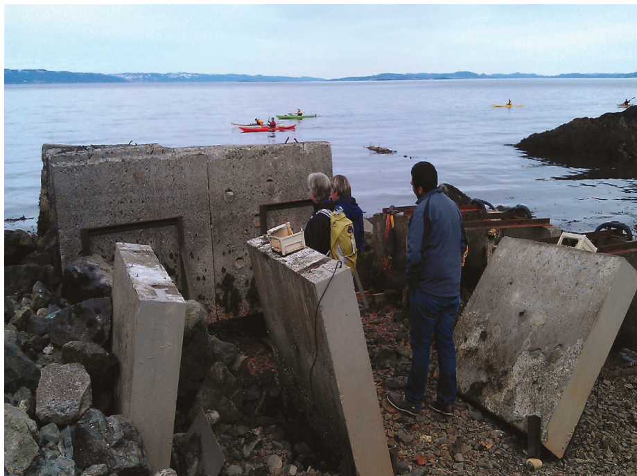
Betongkonstruksjoner som eksponeres for sjøvann, kan bli angrepet av armeringskorrosjon. Her testes en konstruksjon i tidevannssonen i Trondheimsfjorden. Foto: Klaartje De Weerd
