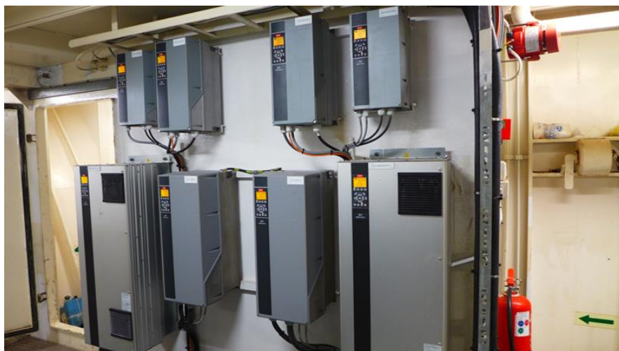
Figur 5. Frekvensstyring av RSW-pumper, ammoniakk- og kondensatorpumper samt kompressorer.
